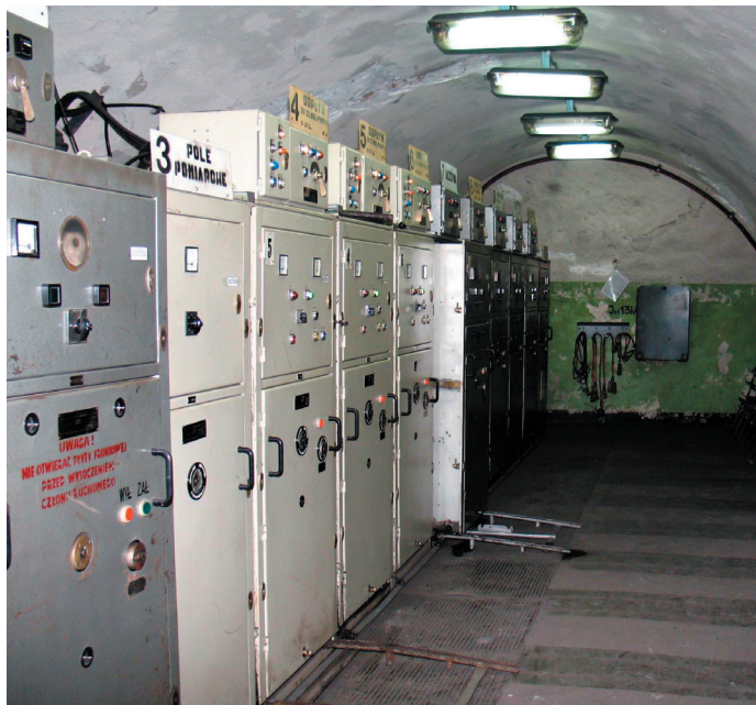
Ryc. 4. Dołowa rozdzielnia 6 kV z polami typu RSK 6
